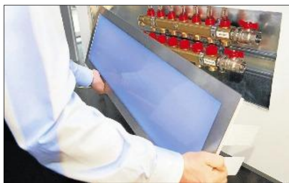
Schick und weg: Der LED-Design-Verteilerschrank verhüllt die Regeltechnik für die Fußbodenheizung mit einem schicken Rahmen und weichem Flächenlicht. Foto emcal
